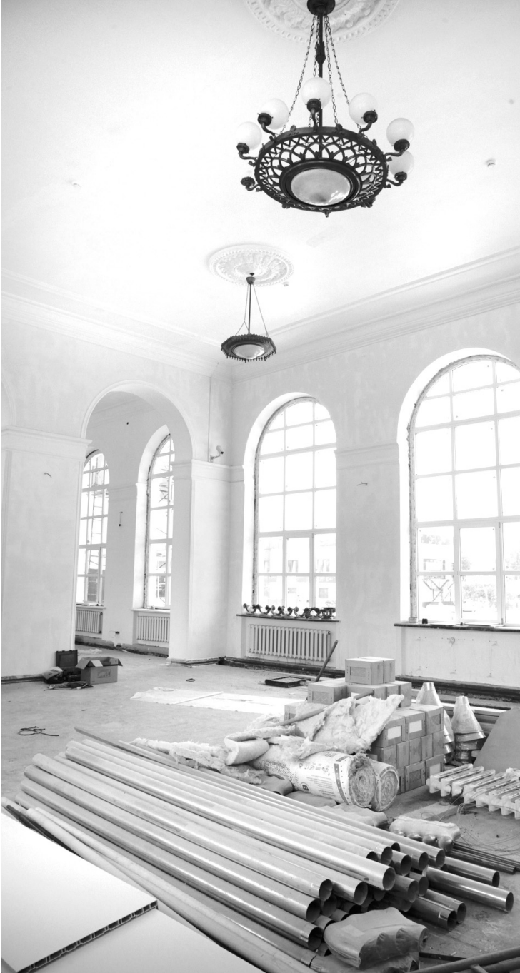
Зал ожидания – в ожидании капитального ремонта
