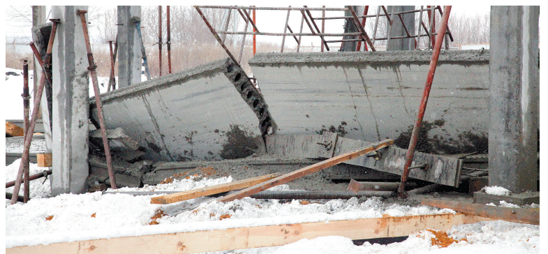
Одиннадцать бетонных плит рухнули во время строительных работ
