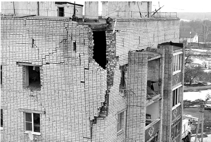
Жильцы разрушенных квартир временно размещены в одном из гостиничных комплексов города
