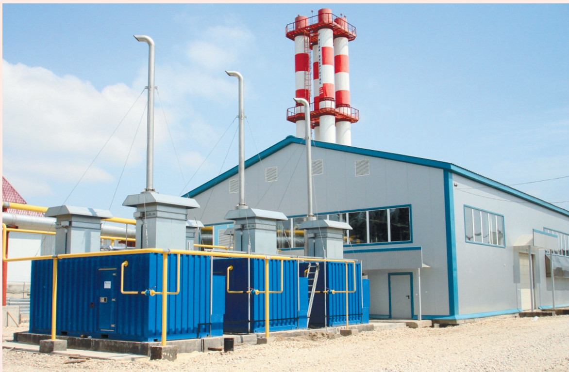
Котельная БМК-80,0 в Волгограде
