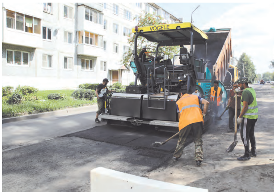
По поручению Алексея Дюмина в Тульской области созданы мобильные бригады для оперативного ямочного ремонта дорог
