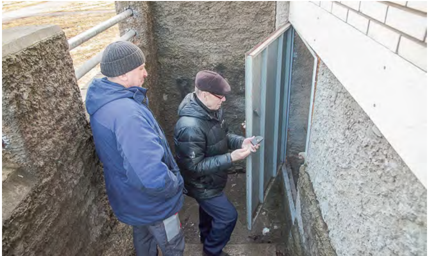
Если бы не помощь пенсионера из соседнего подъезда, в подвал сотрудники ЖЭК могли бы и не попасть
